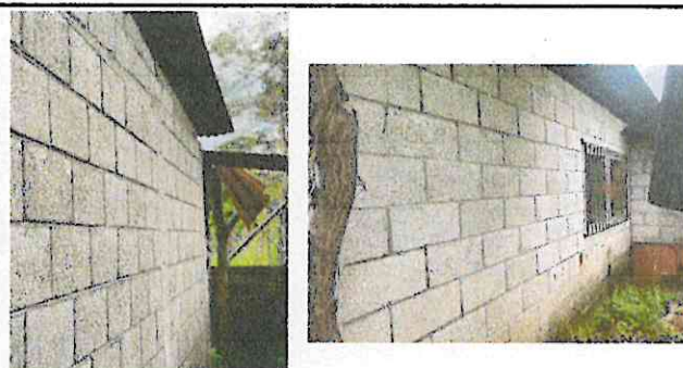
Foto 6: PAREDES SIN REPELLO
